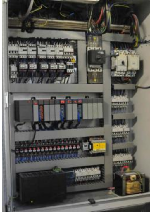
کنترل و مانیتورینگ تابلوهای روشنایی و اصلی
