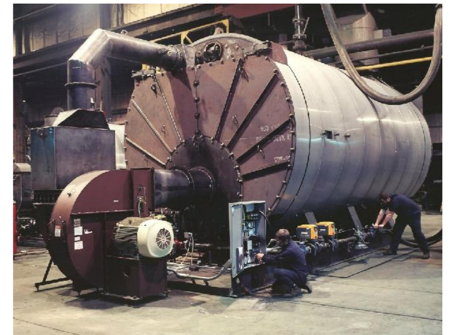
کنترل و مانیتورینگ بویلرها
