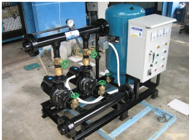
کنترل و مانیتورینگ پمپ ها
